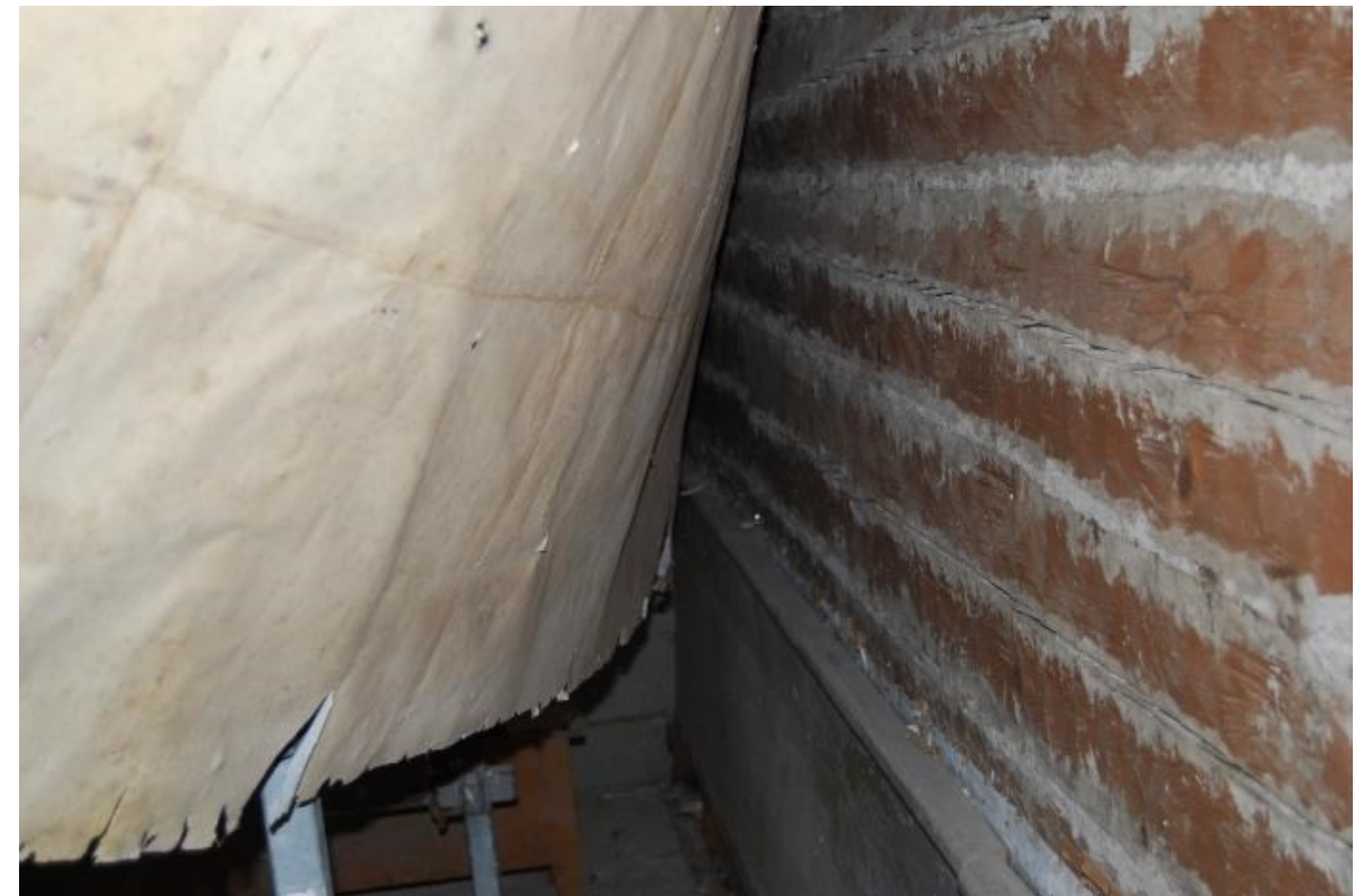
Kuva. Päätysalin paperointia nurjalta puolelta. Vuodiksi liimatut paperiarkit on pingotettu seinille. Myöhemmin paperia on kiristetty alareunasta leikkaamalla ja lisäämällä nupirivi. Seinien varausraoissa on savilaasti. Kuvan alaosassa näkyy rintapaneelin yläreuna. Kuva 2008 T.L
