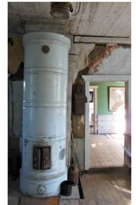
Pönttöuuni on alun perin muurattu vuonna 1928 palomuriin tehdyn merkinnän mukaan. Uunin sisäosat ja perustus vaihdettu vuonna 2010. Muurarina Kai Ristimäki
